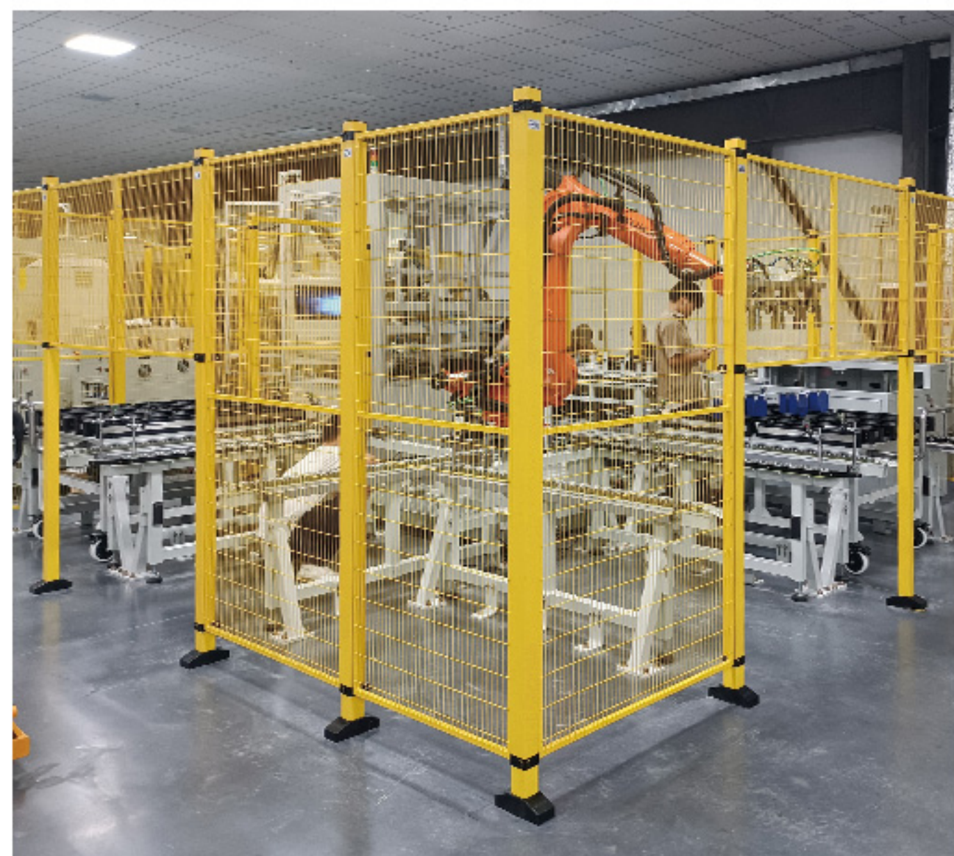
◆ 新能源电池线安全防护
